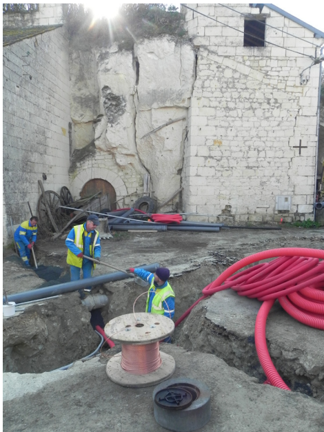
Risques d'éboulements rocheux dus aux vibrations des engins mécaniques.
