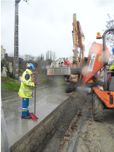
Intempéries et ruissellement dans les tranchées.
