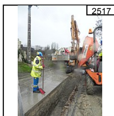
2517 Tranchée remplie par l'eau de pluie
