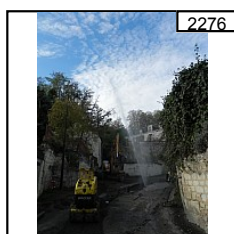
Percement d'une conduite d'eau.
