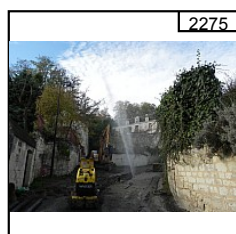
Percement d'une conduite d'eau.
